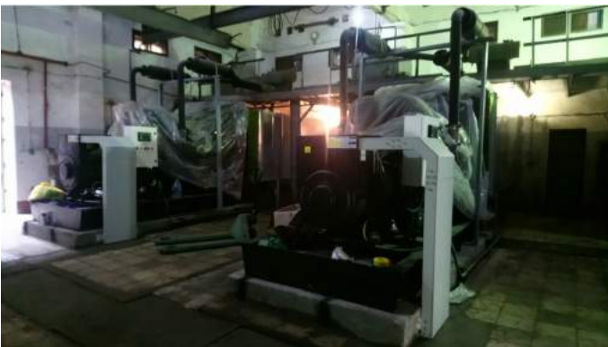
Nhà máy Nhiệt điện Phả Lại
